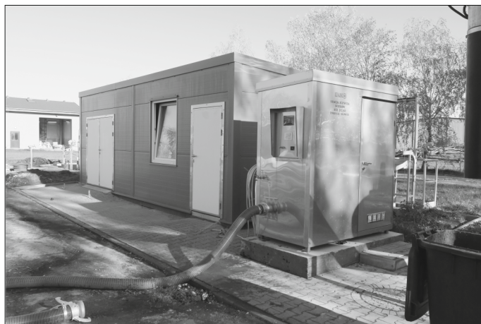
Stacja zlewna ścieków dowożonych
