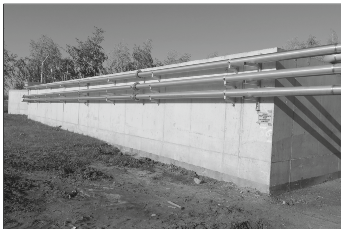
Komora nityfikacji z rurociągami recykulacji zewnętrznej i rurociągami osadu nadmiernego.
